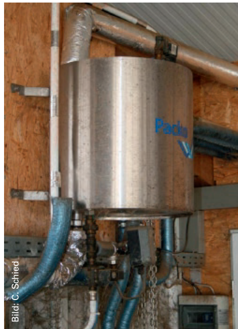
Milchkühlung hat ein großes Energiesparpotential.
