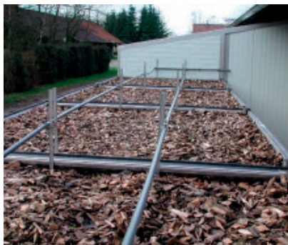
Bild 2 Abluftfilter mit Hackschnitzeln als Trägermaterial für Mikroorganismen
